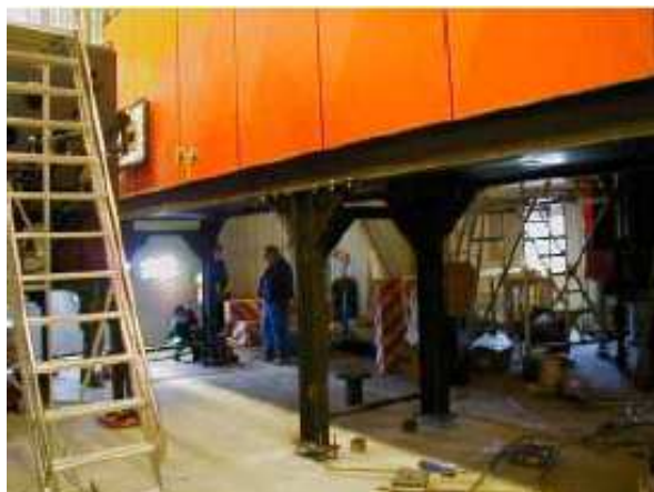
Widok instalacji za komorą spalania
