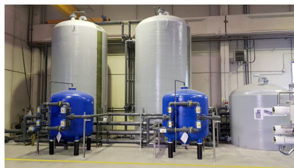
Stanowisko testowe dla dużych urządzeń, Hiszpania
